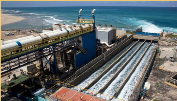
Usine de dessalement d'eau de mer Source : Finances News Hebdo - sept.2022
